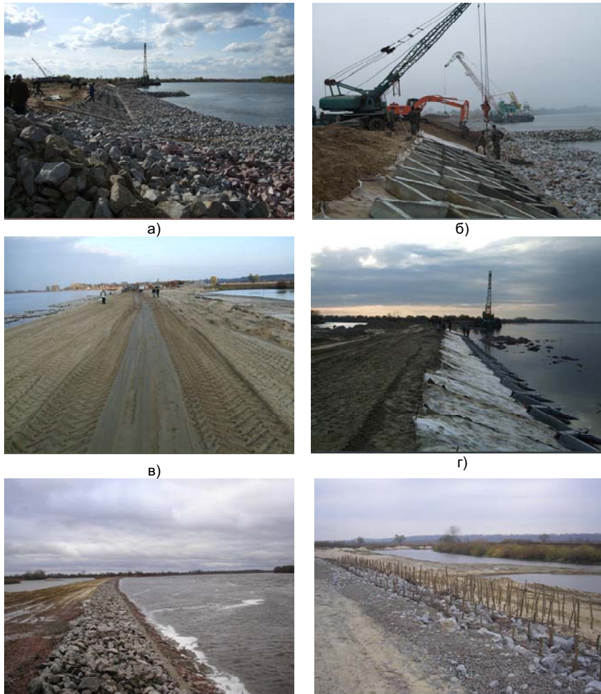
Рис. 1. Будівництво II-ї черги берегоукріплення р. Дніпро біля смт Любеч: а) берегоукріплення лівого берега накидом із каменя; б) монтаж клітинок із залізобетонних балок; в) насипка відсікаючої греблі; г) влаштування зворотнього фільтра з нетканого геотекстилю; д) закріплення лівого берега р. Дніпро; е) кріплення укусу греблі лісою з вербового хмизу
